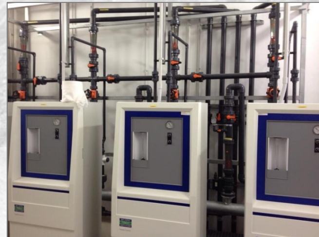
Dosificación y mezcla de cloro gas en planta potabilizadora
