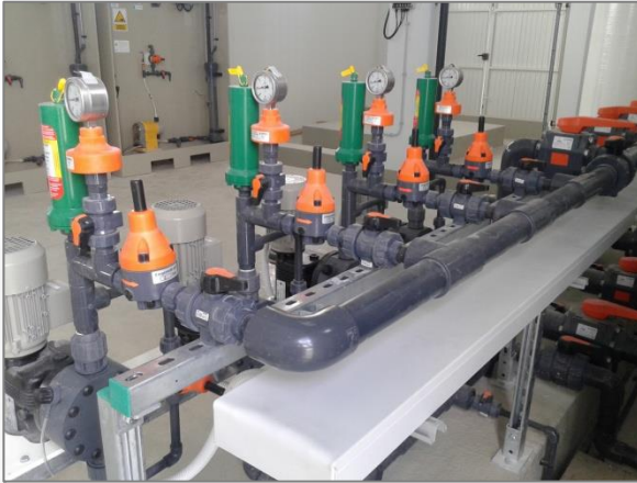
Dosificación de dióxido de cloro
