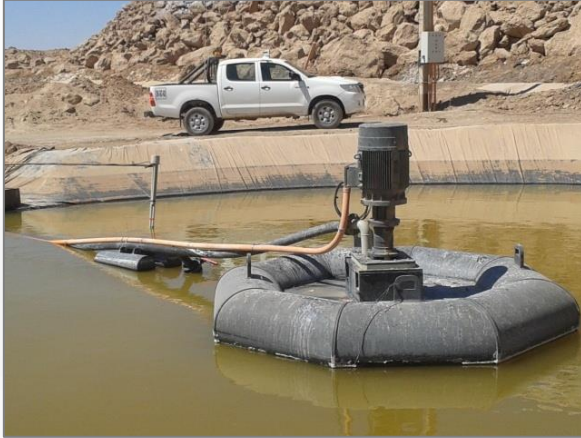
Bombas flotantes ETL en lixiviados
