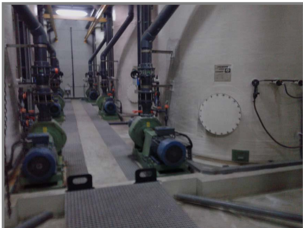
Recirculación de agua con reactivos en torres de lavado de gases
