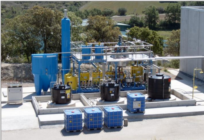
Planta tratamiento agua residual
