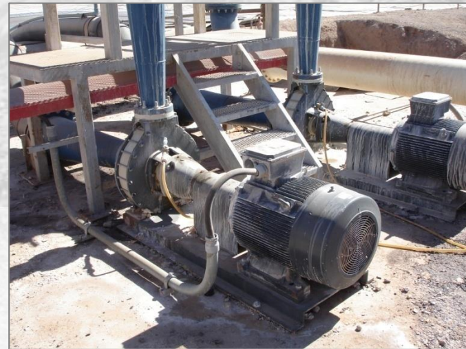
Bomba centrífuga horizontal con lixiviados
