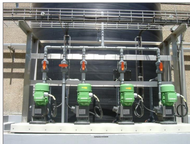
Dosificación químicos para scrubbers
